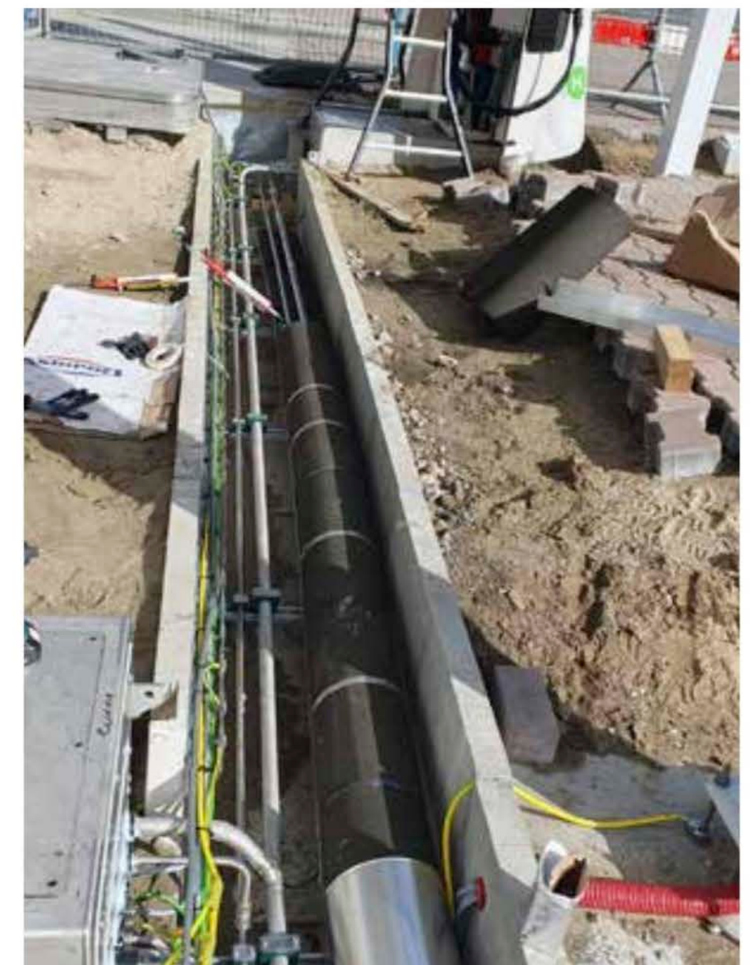
Voor de waterstofleidingen is gekozen voor Foamglas (cellulair glas) afgewerkt met aluminium beplating
